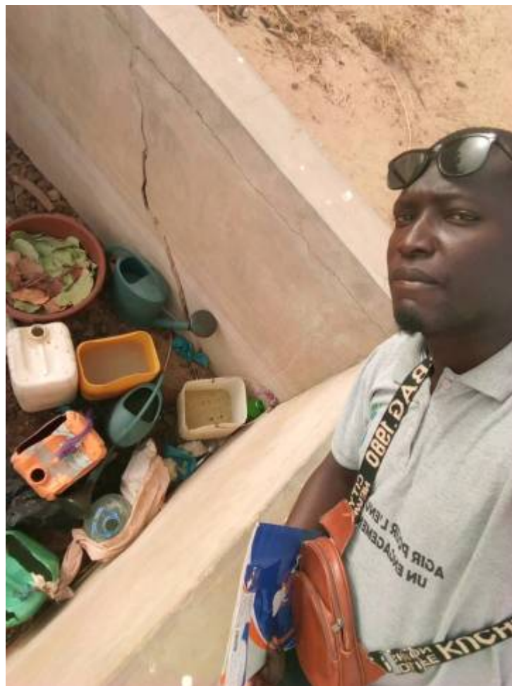
Mansour Gaye, le formateur d'AFS nous montre le bassin d'Athiou qui s'est fendu au bout d'un an ! On arrête cela !
